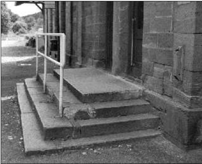
Baufälliger Zugang zum Bahnhof Jossa (Fotos: Werner Filzinger)
